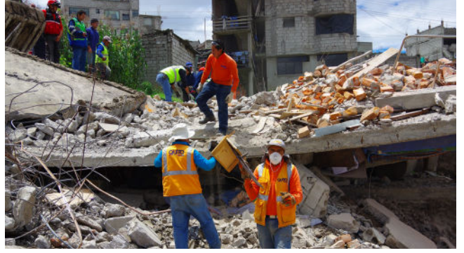
Görsel 1.3.2: Deprem sonucu yıkılmış bina
